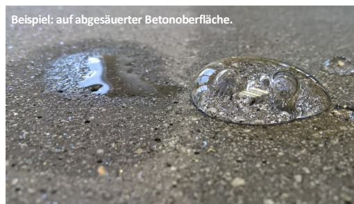
Links: ungeschützt Wasser dringt ein
